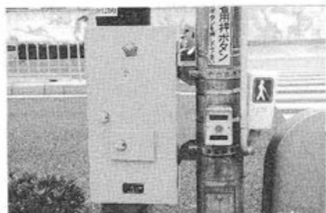
写真1 信号制御機、押ボタン箱
